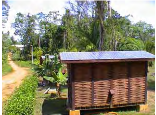
Générateurs photovoltaïques (commune de Saül)
