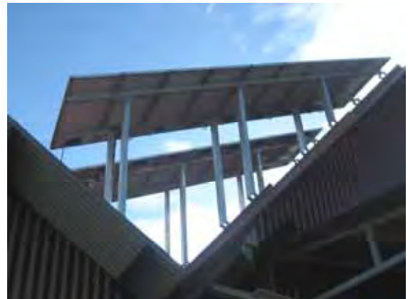
Modules photovoltaïques montés en toiture (commune de Montsinéry)
